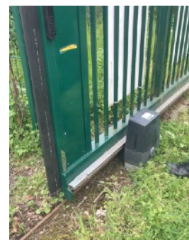
Barrière à l'entrée du plan d'eau dégradée et alimentation électrique sectionnée !
