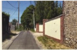
Mur plus classique (parpaings enduits avec sous-bassement et pilars en briques) qui s'inspire des teintes des matériaux traditionnels.
